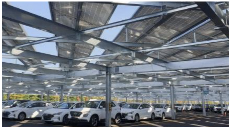
(상단부터 순서대로) 인도공장 지붕 위 태양광 페배터리 ESS 울산공장 차량 주차장 내 태양광 발전 설치
