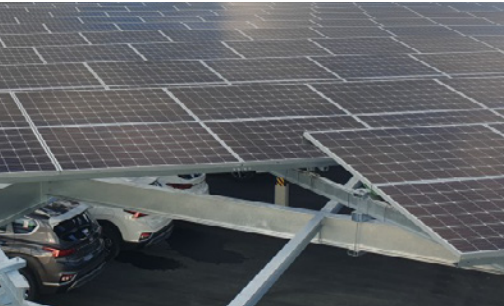
울산공장 태양광발전 설비
