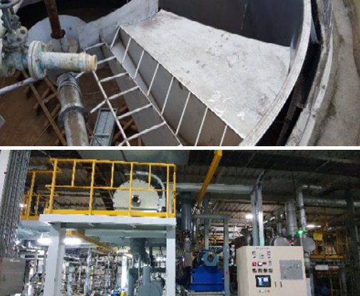
상. 울산공장 52도장 가압부상조 하. 아산 공업용수정수장 증발농축기 설치
