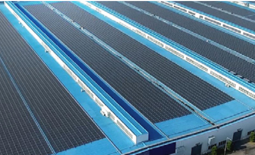
아산공장 지붕형 태양광 발전 설비
