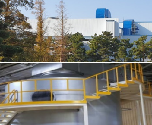
상. 울산 도장1공장 농축 RTO 하. 아산 도장공장 집진설비 교체
